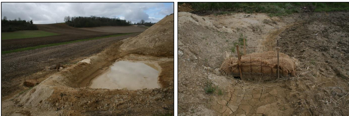
Figure 64 : bassin de décantation temporaire des eaux de ruissellement en phase de chantier avec filtre à paille en sortie
